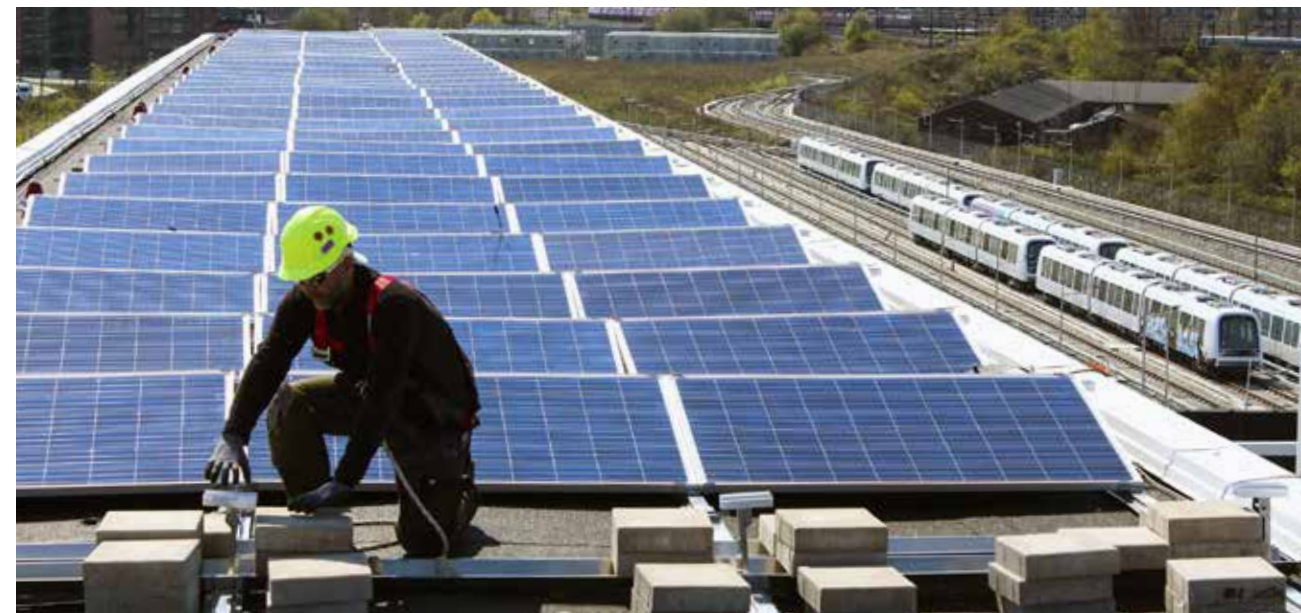
Kontrol- og vedligeholdelsescenteret i Vasbygade blev i 2016 udstyret med solceller.
