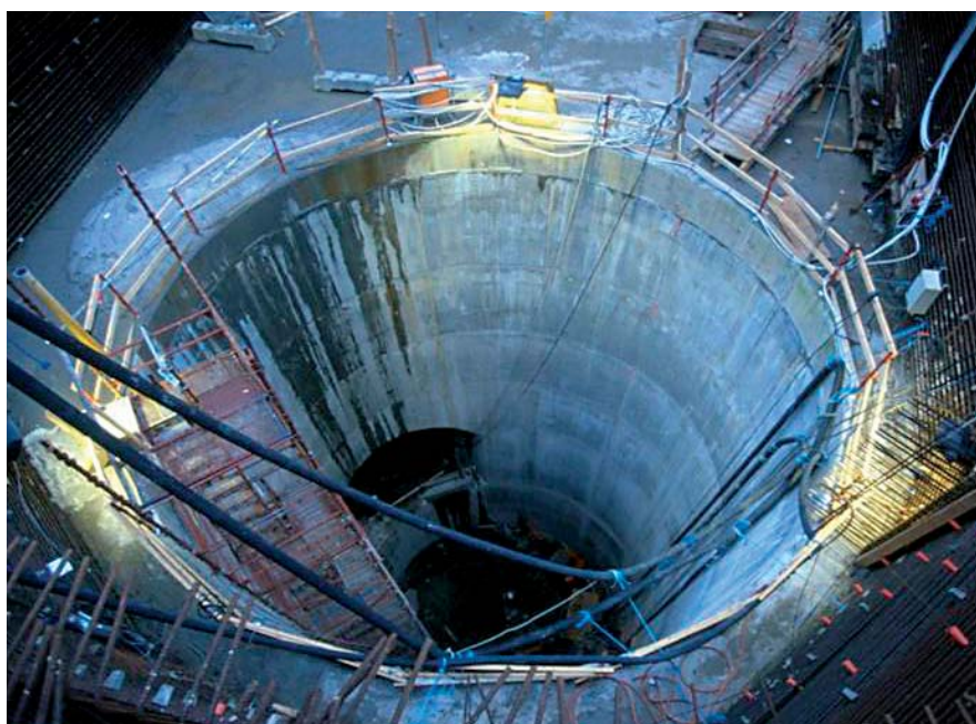
Figur 4.11 Skakt foret med beton på indersiden for opnåelse af jævn og tæt overflade, Københavns Metro.
